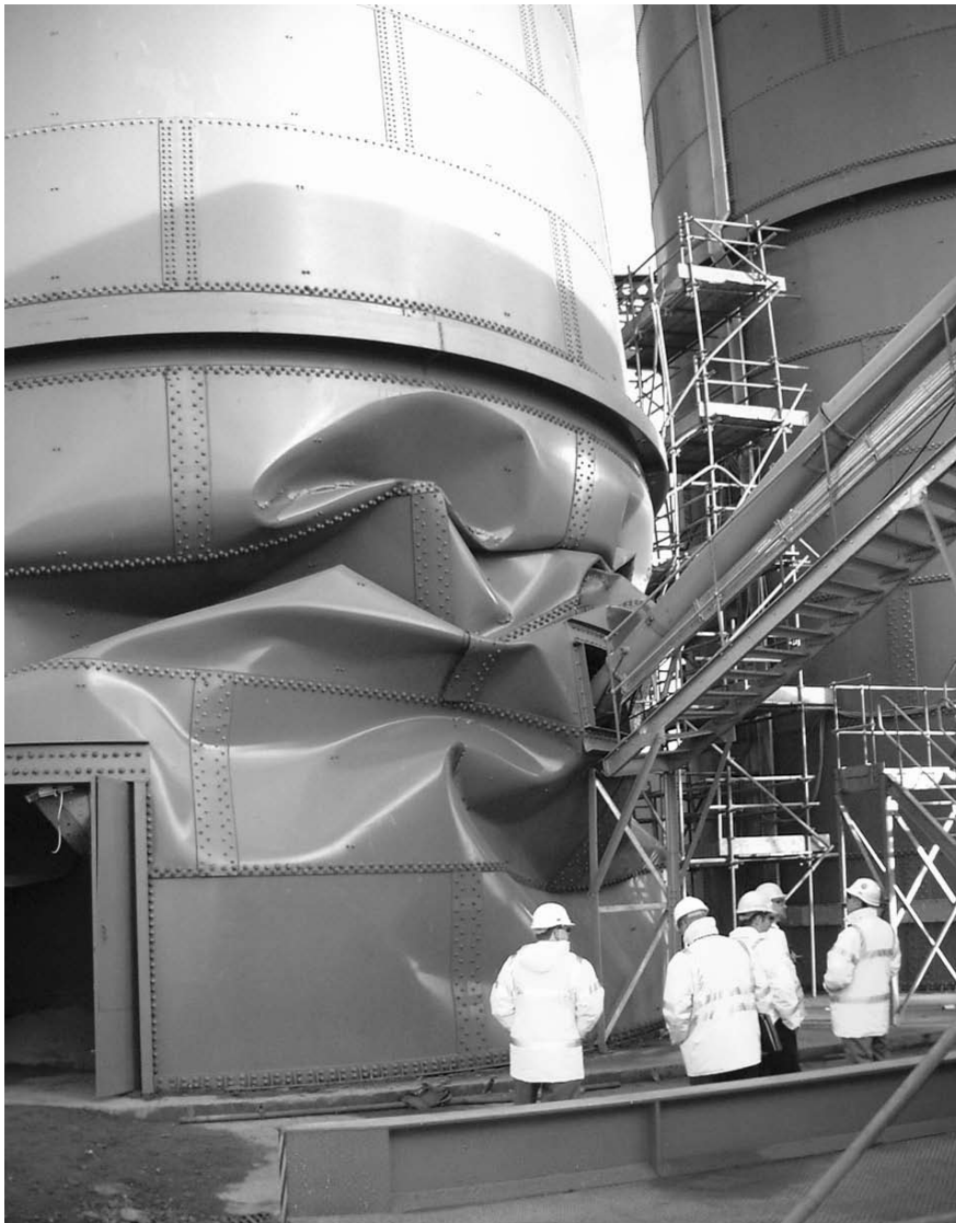
(8) Beulen in der „Standzarge“ eines Silos. Foto: J.M. Rotter, Edinburgh
